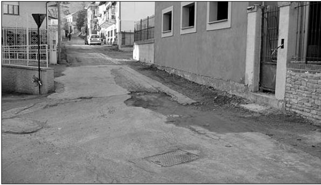
Canelli. Alcuni abitanti di via Bertolini (una traversa di via Alba) ci hanno segnalato come il manto stradale nel tratto iniziale della Via sia in uno stato a dir poco pessimo con buchi di ogni tipo, avvallamenti, tratti di asfalto completamente mancanti ormai da più di due anni. La situazione è stata più volte segnalata all'ufficio tecnico comunale. La colpa pare sia dovuta ai lavori per la costruzione e ristrutturazione della vicina Villa Adele, e per la posa dei vari allacciamenti fognari, Enel, Telecom, dell'acquedotto senza poi ripristinare il manto di asfalto che ora è ridotto ad un colabrodo. Meno male che quest'inverno non ha mai piovuto o nevicato altrimenti il fango l'avrebbe fatto da padrone. Sarebbe opportuno in tempi brevi il totale ripristino dell'asfalto dei 50 metri iniziali, da parte di chi di competenza, per poter transitare in sicurezza per tutti: pedoni, ciclisti e autovetture. Agli organi preposti ribaltiamo il problema nella speranza di una veloce risposta. Nella foto come si presenta via Bertolini.
