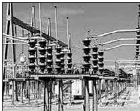
Sistemi elettrici di potenza
