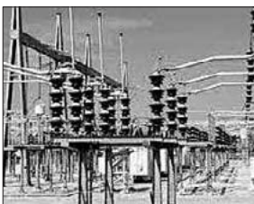
Sistemi elettrici di potenza
