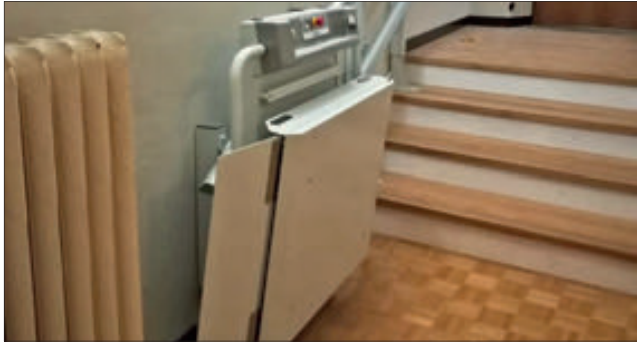
▲ Sollevatore per disabili
