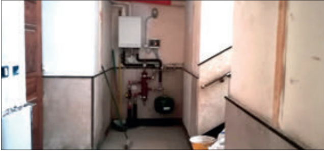
▲ Nuova centrale termica per riscaldamento a pavimento
